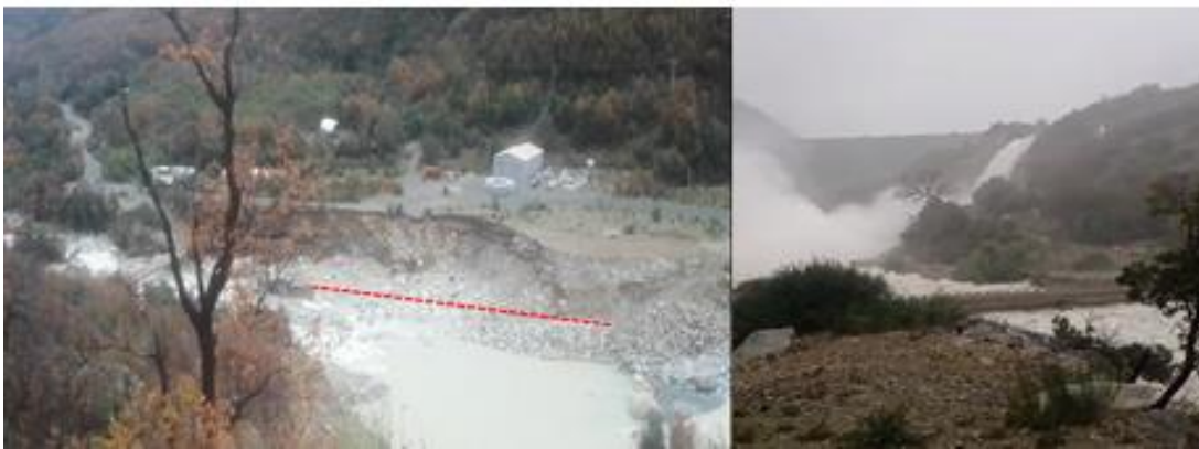
Figura N° 8: Vista del foso de disipación después (izq.) y durante (der.) el evento del 24 de junio 2023.
