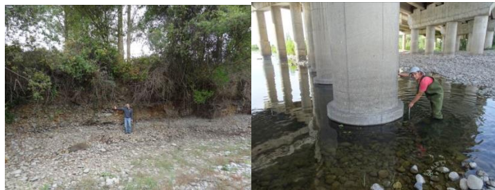
Figura 2. Ejemplos de degradación cauce observado (izquierda) y socavación local (derecha)
