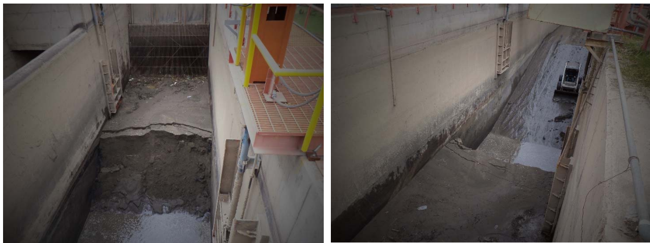
Figura 3. Fotografías cámara de carga Chacabuquito durante limpieza mecánica
