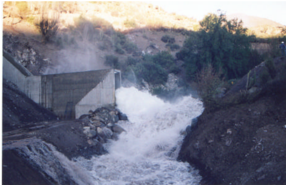
Foto 4 Disipador de energía
